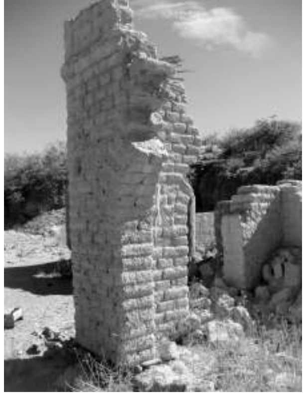
Figura 21. Detalle de la única sección de un arco que se conserva en el sitio.
